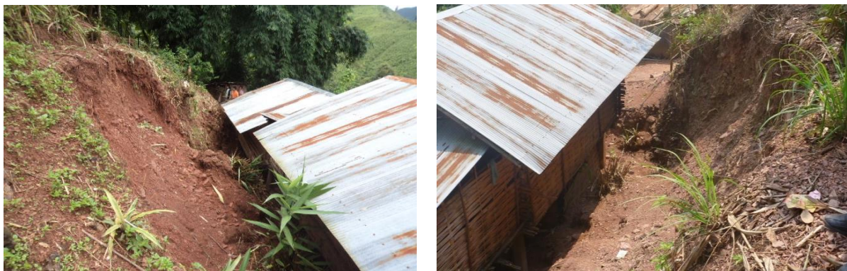
ภาพที่ 35 ลักษณะการปลูกสร้างบ้านเรือนที่มีความเสี่ยงต่อการเกิดดินถล่ม ใน พ.ศ. 2555 และเป็นพื้นที่ก่อน ดำเนินโครงการป้องกันภัยดินถล่มโดยการใช้หญ้าแฝกร่วมกับวิธีกลและพืชอื่น ที่มา: สุเชษฐ์ ลิขิตเลอสรวง และคณะ (2561)
