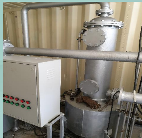
รูปที่ 7 Scrubber
